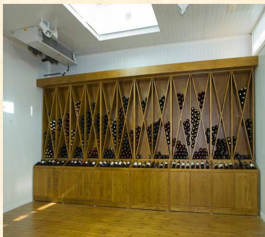
Evaporador instalado zona de vinoteca
