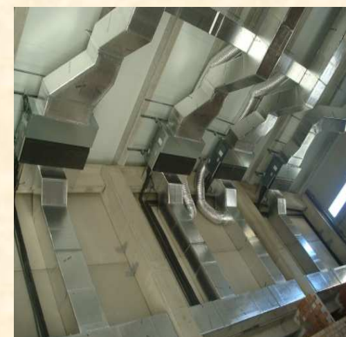
Detalle de conductos de climatización
